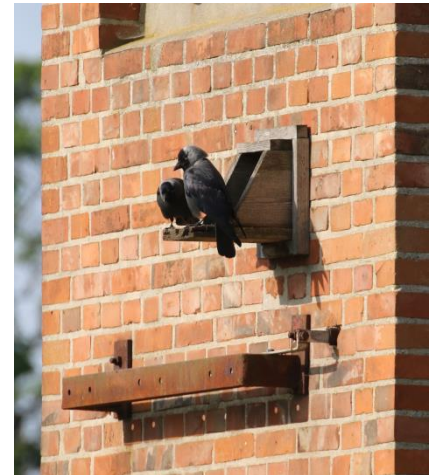
Abb. 1: Dohlenpaar am Trafo Lohmen (Foto: J. Loose)
