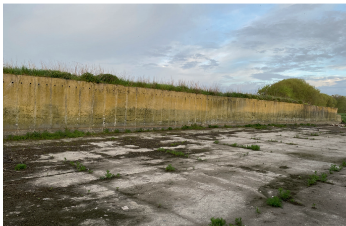
Abb. 21: Seit Jahren brüten in den Löchern der Betonelemente des Silos am Polder Rodde/VR Uferschwalben Riparia riparia . Die Betonelemente sind angeschüttet mit Mutterboden (Foto: F. Vökler).
